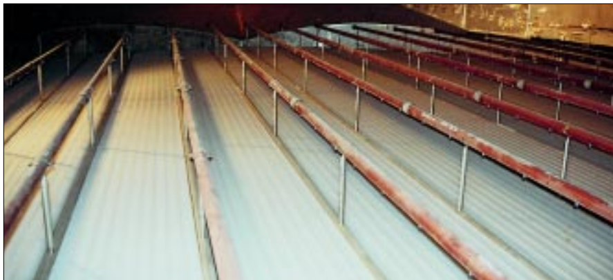
LTV 271 Séparation fine dans une installation de désulfuration de gaz de fumée
