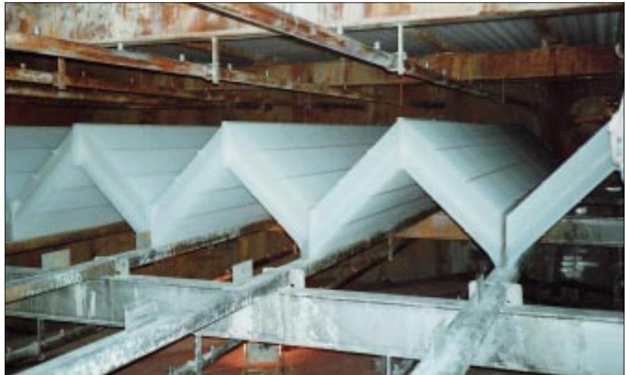
LTV 110.33.B dans une tour de lavage
